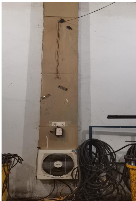
图片 10 排风系统
